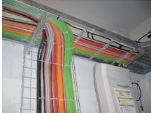
Tracé de câbles dans le stade pour la desserte des différents sites
